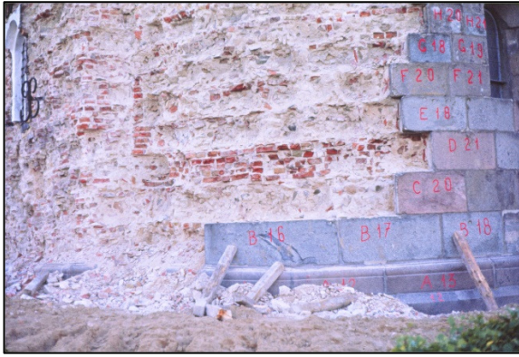
Kirkens apsis, da murkernen er blotlagt – der ses rester af teglsten anvendt i murkernen ved en ommuring i slutningen af 1700-tallet
